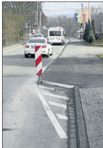
Zustand 2011: Nach 25 Jahren immer noch eine provisorische Stolperkante. Foto: Thiele
