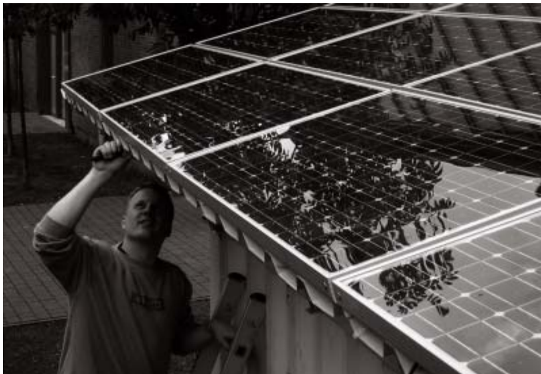
Letzte Handgriffe: Tobias Martin, Student der Uni Kassel, bei der Montage der Solarstromanlage für Gambia. Foto: ISET
