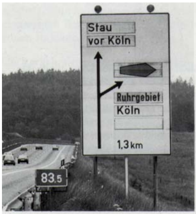
Abbildung 4: Verkehrslenkungsanlage Dernbach-Koblenz (A48)
