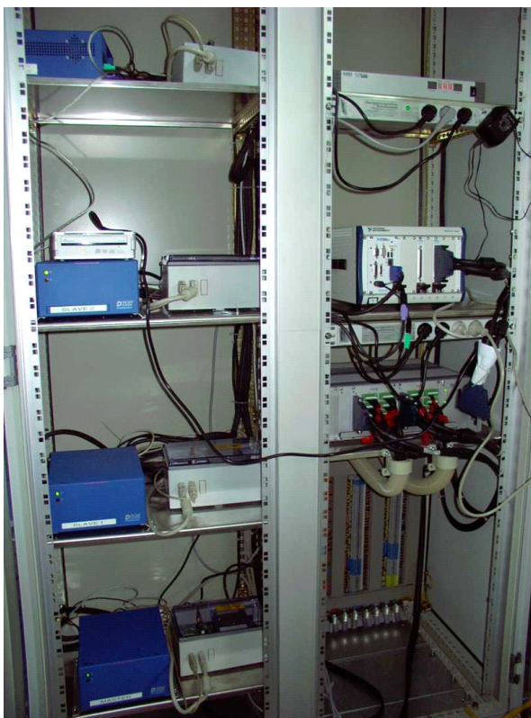
Bild 6.48: Das MIDR im Steuerschrank
