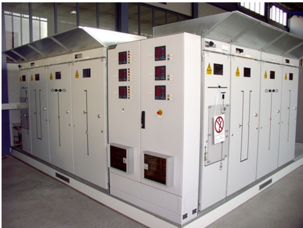
Bild 4.5: Ausführung der Mittelspannungsnetznachbildung im DeMoTec des ISET
