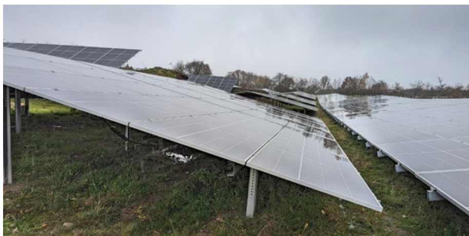
Abb. 2: Niedrige Paneele, herabhängende Kabel und vorstehende Metallkanten: Die Verletzungsgefahr auf dieser Anlage ist groß und Aufwuchs kaum vorhanden. (Foto: D. Mühlrath)
