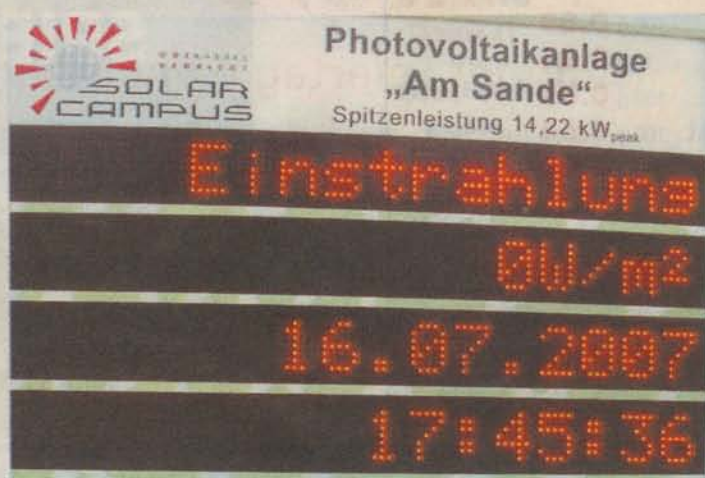
Die Photovoltaikanlage „Am Sande“ wurde im Rahmen des studentischen Projektes solar-campus der Universität Kassel konzipiert und am 29.12.2006 in Betrieb genommen. Die Anlage besteht aus 79 polykristallinen Mitsubishi-Modulen mit einer Kollektorfläche von insgesamt 113 m². Die Dachneigung beträgt 28°, die Dachfläche ist nach Südost ausgerichtet.
