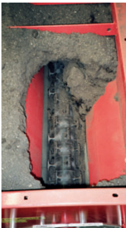
Abb. 1: Brückenbildung in einem Kastenstreuer
