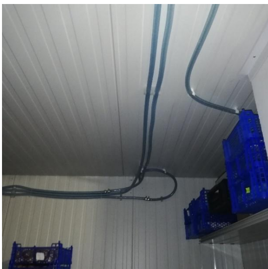
Abbildung 19 Wasserschläuche zur Vortemperierung (DV)
