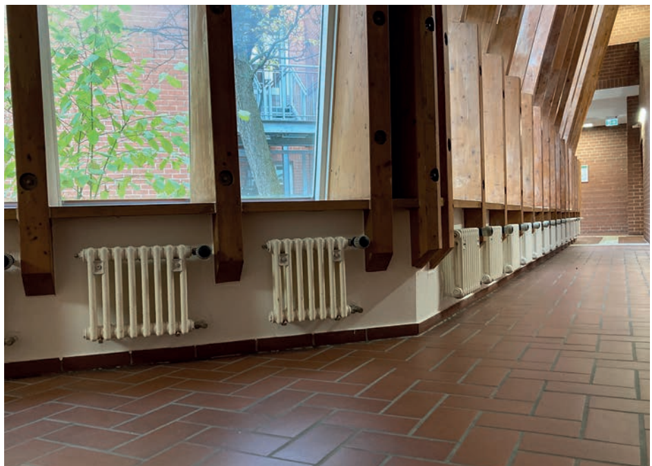
ABBILDUNG: Alte Heizkörper
