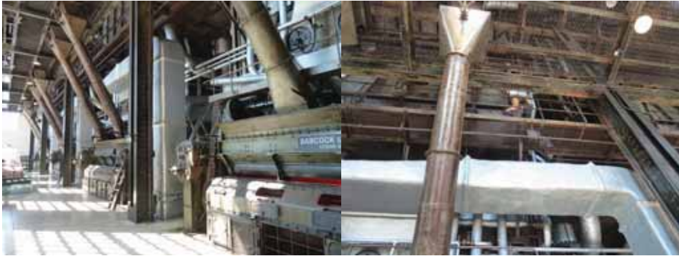
Bild 4: Die Öfen des ehemaligen Kohlekraftwerks in Lissabon Belém.
