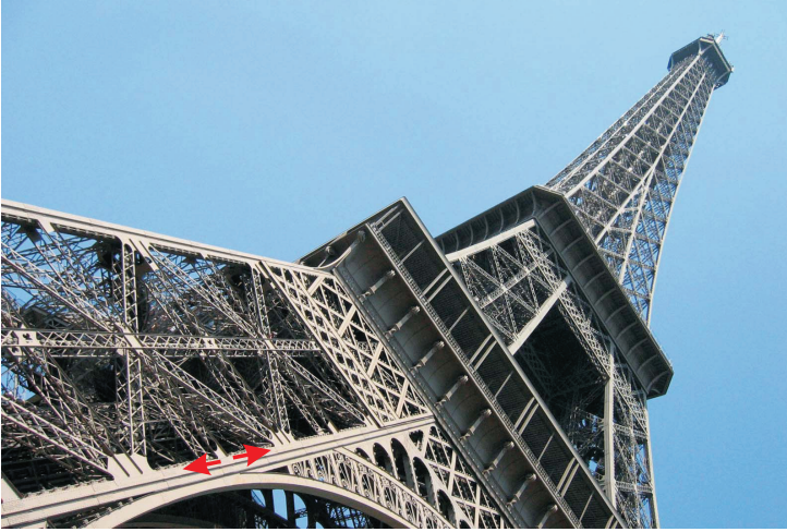
Abb. 2.37 Wenn eine Punktlast an der Turmspitze angreift, dann ist die Normalkraft in der Strebe proportional zur Auslenkung an der Turmspitze, die durch die Spreizung in Achsrichtung verursacht wird
